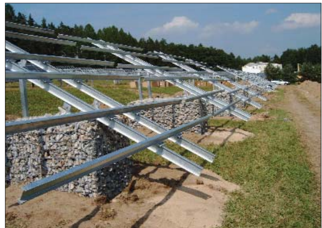
Umweltfreundliche Aufständerung mittels Gabionen
